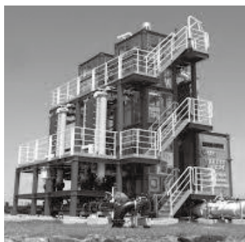
沖合より深層水を汲み上げる施設
